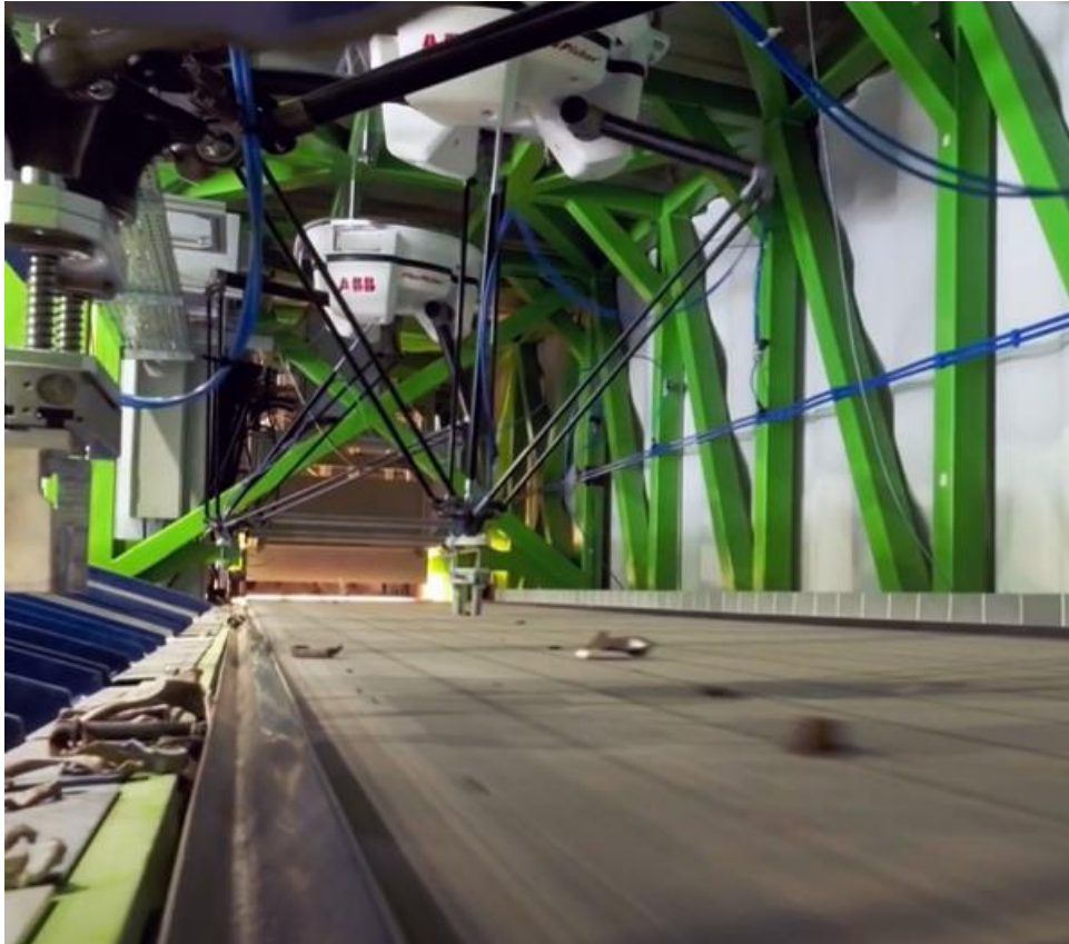
3 robots delta ABB en ligne pour le tri des ferrailles issues des VHU- Projet PICKIT
